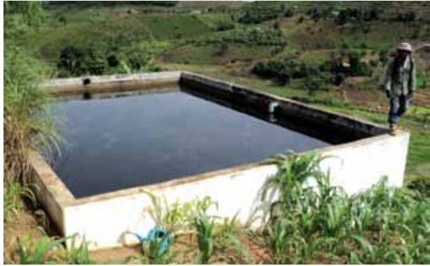
ภาพที่ 143 ถังพักน้ำ ที่เสร็จสมบูรณ์ พร้อมใช้งาน
