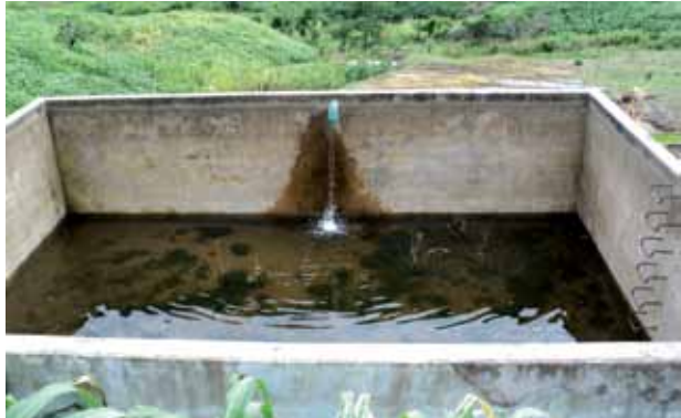
ภาพที่ 144 ท่อน้ำเข้า บริเวณขอบ ถังพักน้ำ
